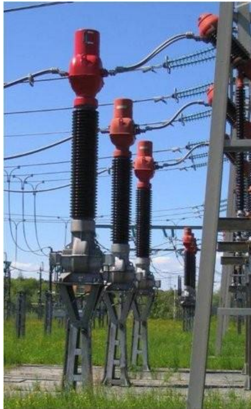
Slika 3. Fotografija kombiniranih transformatora IVOKT 123 u polju
